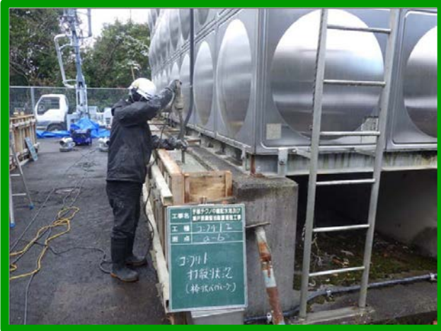
宇部テクノ中継配水池
