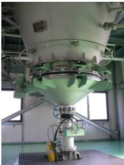
粉末活性炭注入設備（活性炭貯蔵槽下部）
