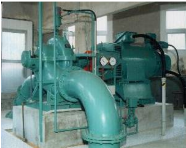
中山浄水場（送水ポンプ）
