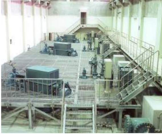
広瀬浄水場（送水ポンプ室）
